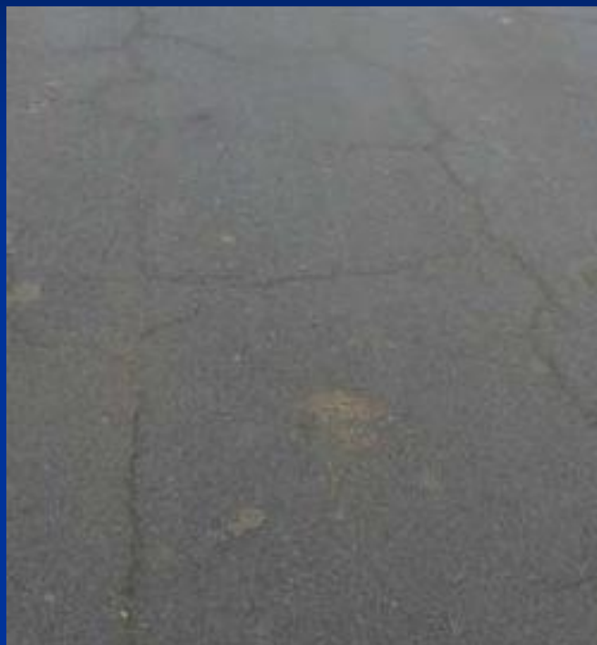
Pukotine na asfaltu
