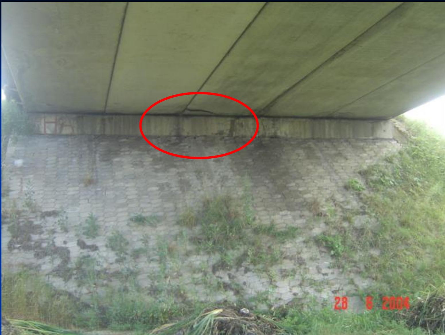
Odlomljavanje raspucalog betona rasponske konstrukcije na mjestu oslanjanja na upornjak
