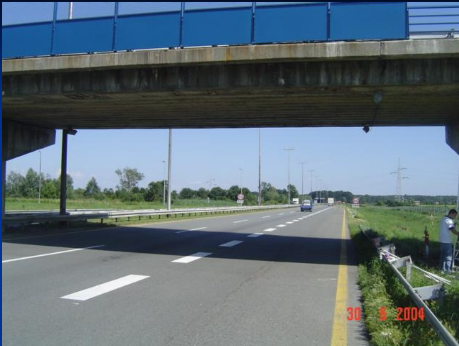
Pogled na nadvožnjak, vidljiva su uznapredovala oštećenja od korozije armature
