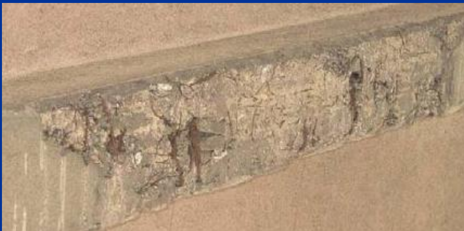
Oštećenje nosača od udara vozila
