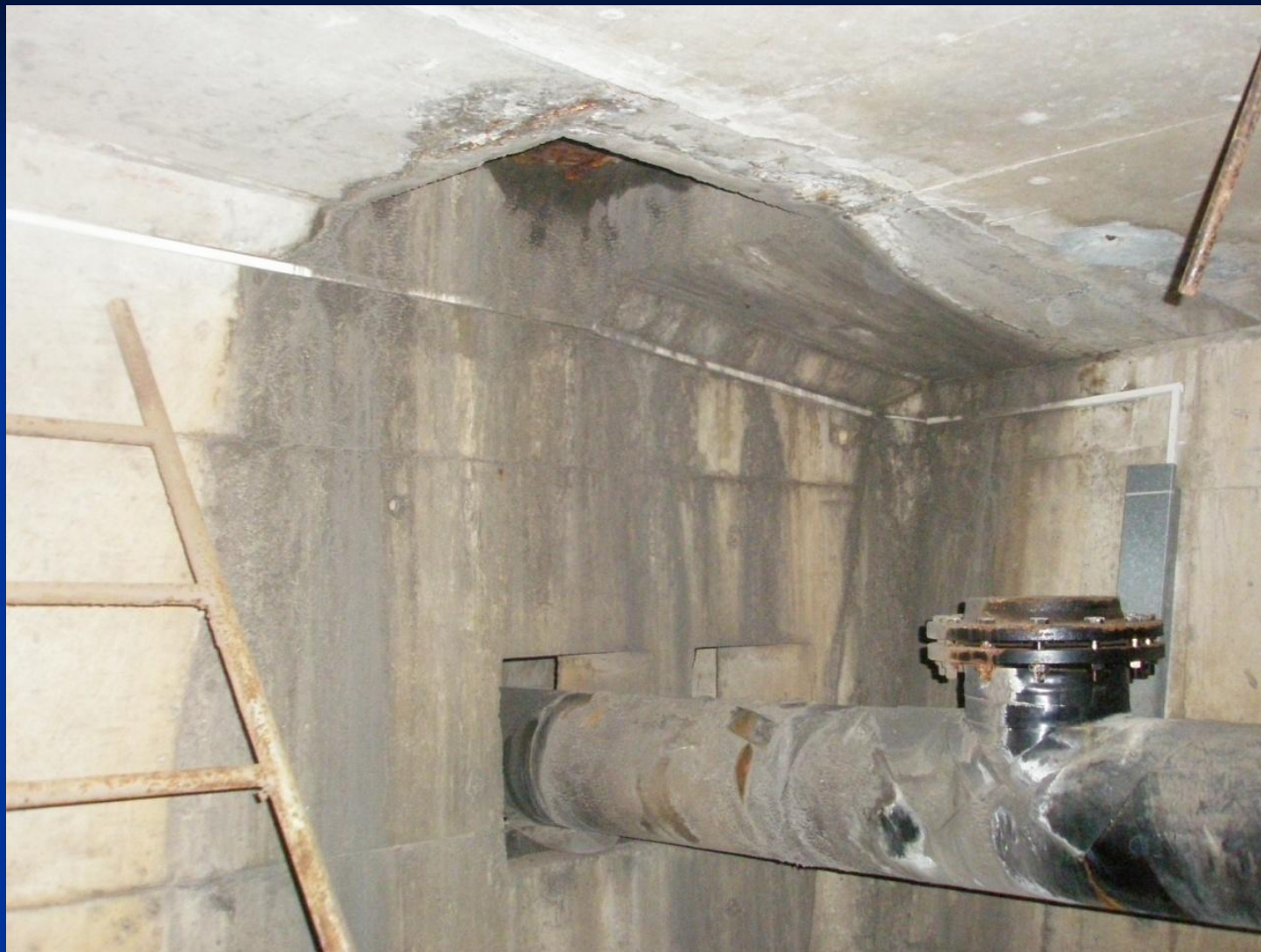
Deatalj šahta u gornjoj ploči nosača sandučastog presjeka kroz koji prodire voda i oštećuje konstrukciju
