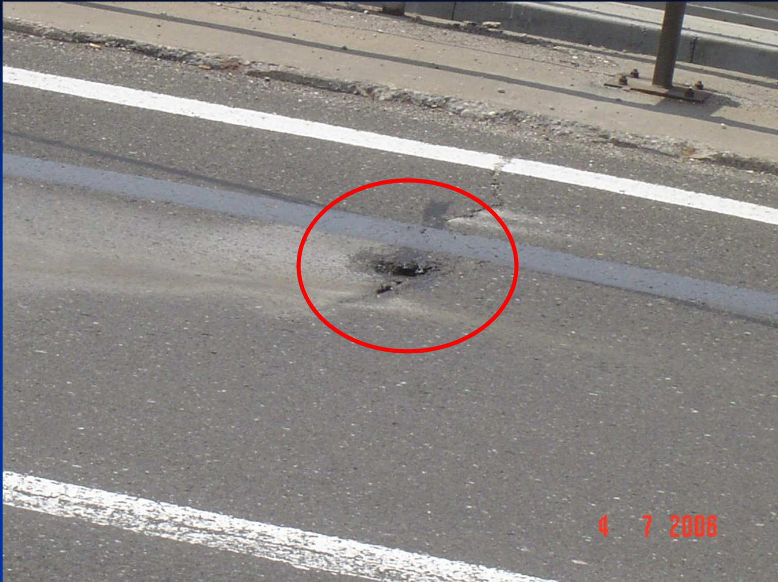
Detalj udarne rupe u asfaltnom kolniku
