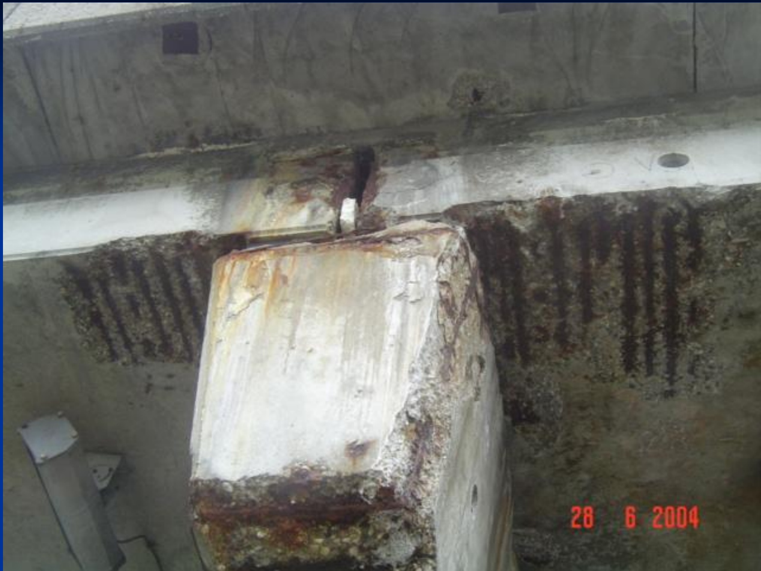
Oštećena naglavna greda i rasponska konstrukcija
