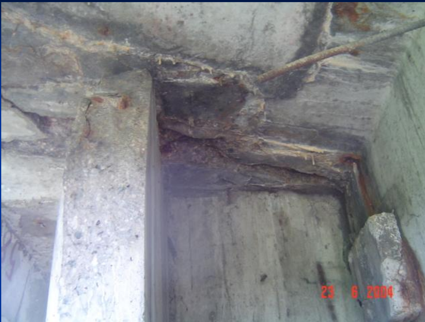
Procurivanje vode kroz raspucani rasponski sklop
