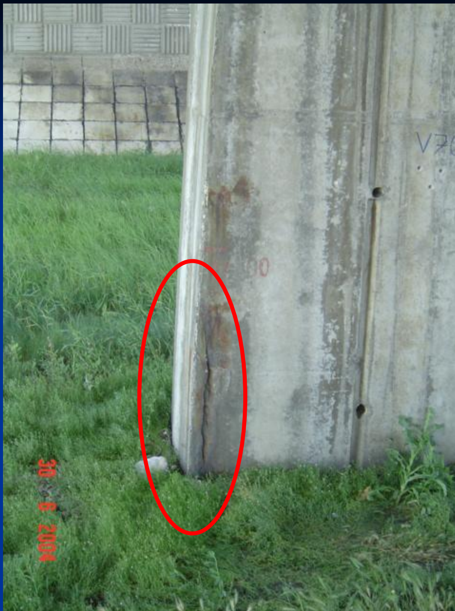
Početak raspucavanja stupa nadvožnjaka zbog djelovanja korozije armature, još ne dolazi do odlamanja betona
