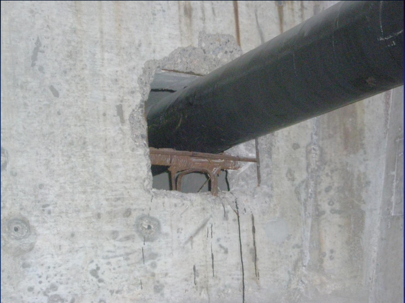
Neodgovarajući detalj oslanjanja cijevi unutar sanduka mosta
