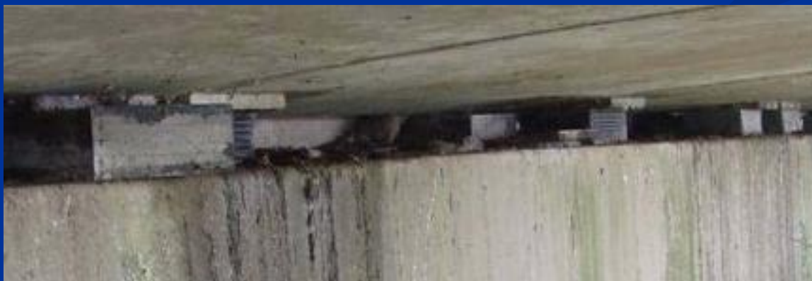
Oštećeni, izmaknuti i ekscentrično opterećeni elastomerni ležajevi
