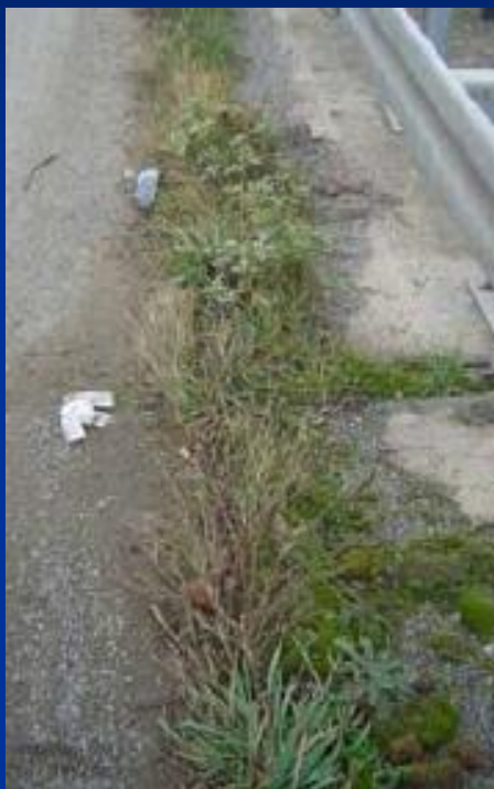
Korov na mjestu spoja rubnjaka i pješakog hodnika
