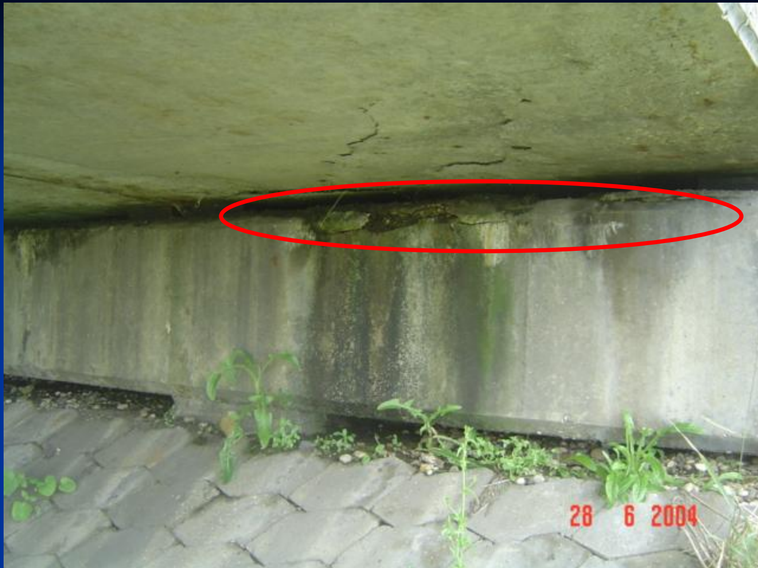
Odlamanje betona ležajne grede na upornjaku na mjestu oslanjanja rasponske konstrukcije
