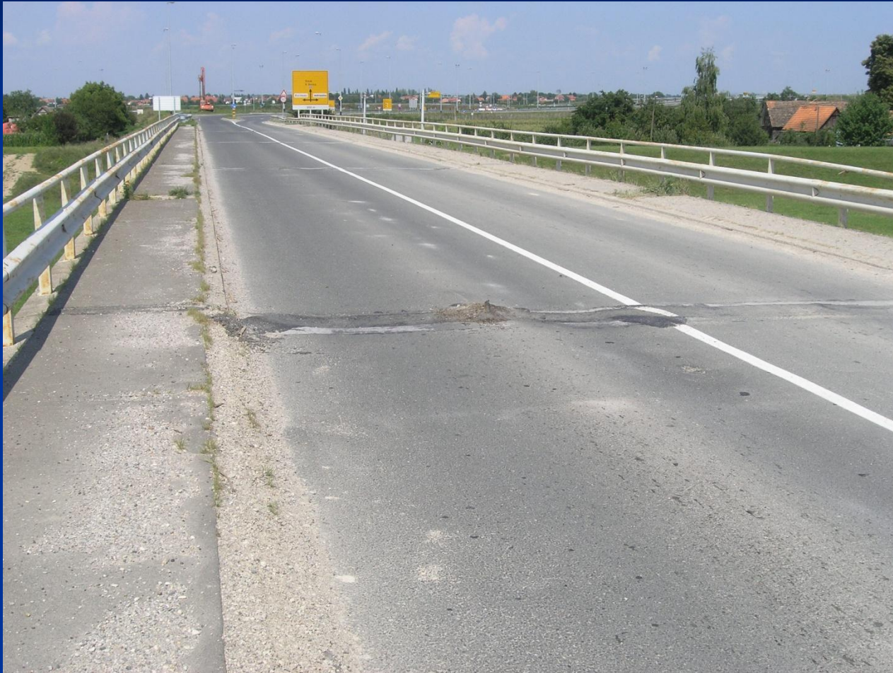
Oštećena pješačka staza i asfaltni kolnik
