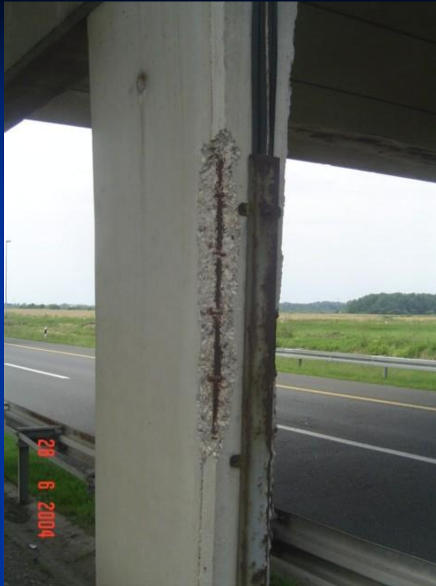
Odlomljeni beton na stupištu nadvožnjaka
