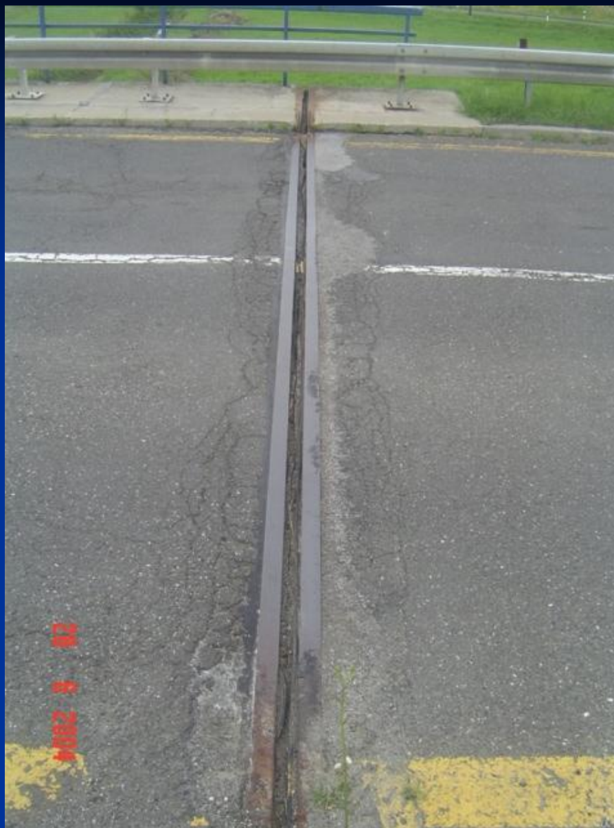
Mrežaste pukotine u asfaltu, neodržavana dilatacijska naprava
