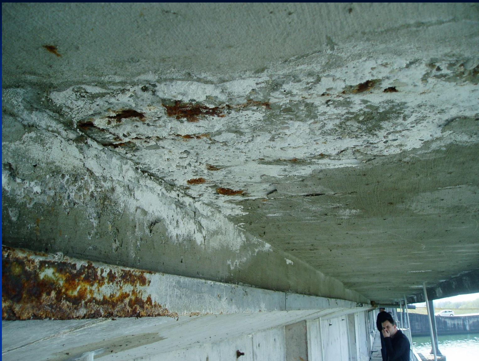
Podgled mosta, vidljivi tragovi korozije armature i iscvjetavanja
