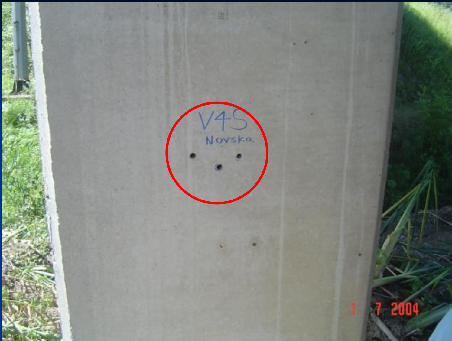
Stup nadvožnjaka u dobrom stanju, vidi se pozicija bušenja betona za određivanje sadržaja klorida
