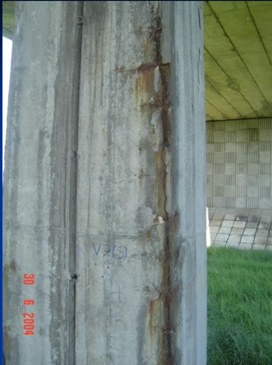
Raspucavanja stupa nadvožnjaka zbog djelovanja korozije armature, vidljivo je odlamanje betona
