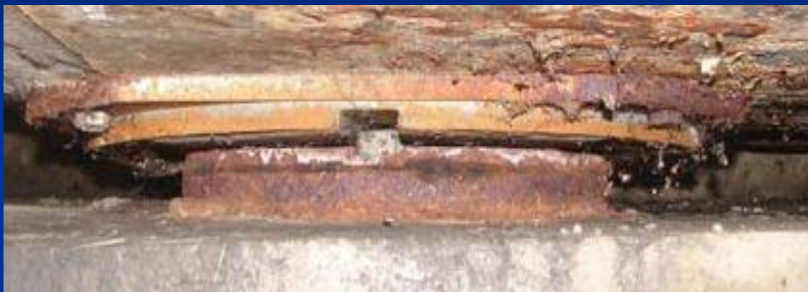
Oštećeni lončasti ležaj
