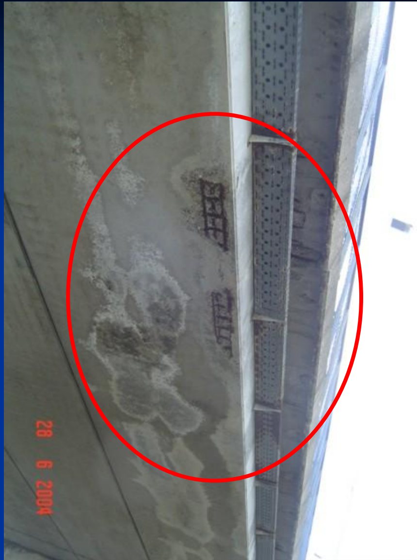
Podgled rasponske konstrukcije s vidljivim oštećenjima pješačkog hodnika
