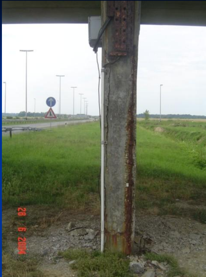
Oštećeno stupište nadvožnjaka
