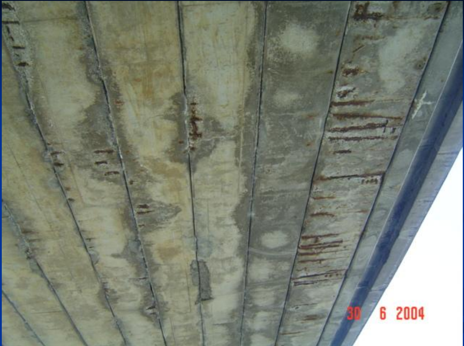
Podgled rasponske konstrukcije, vidljivi tragovi korozije
