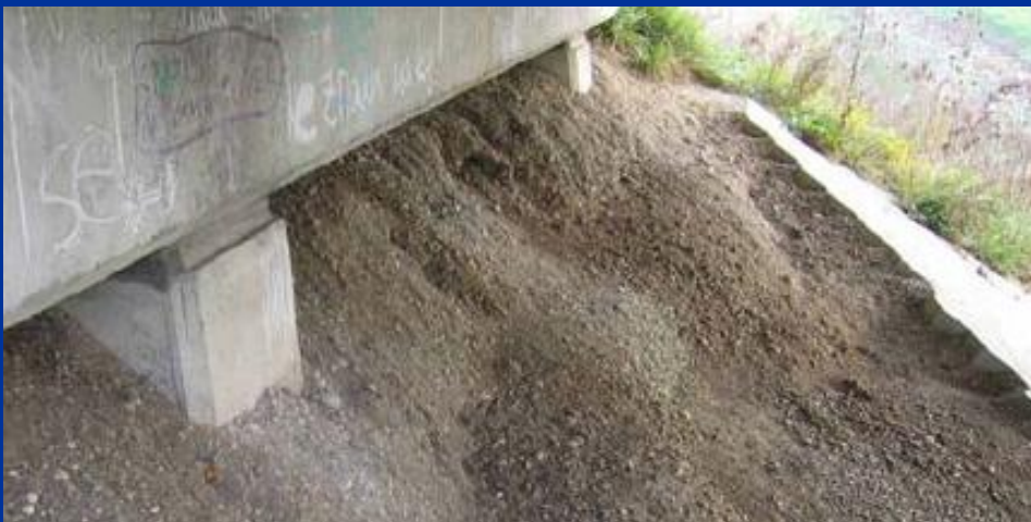
Karakteristično podlokavanje nasipa nadvožnjaka
