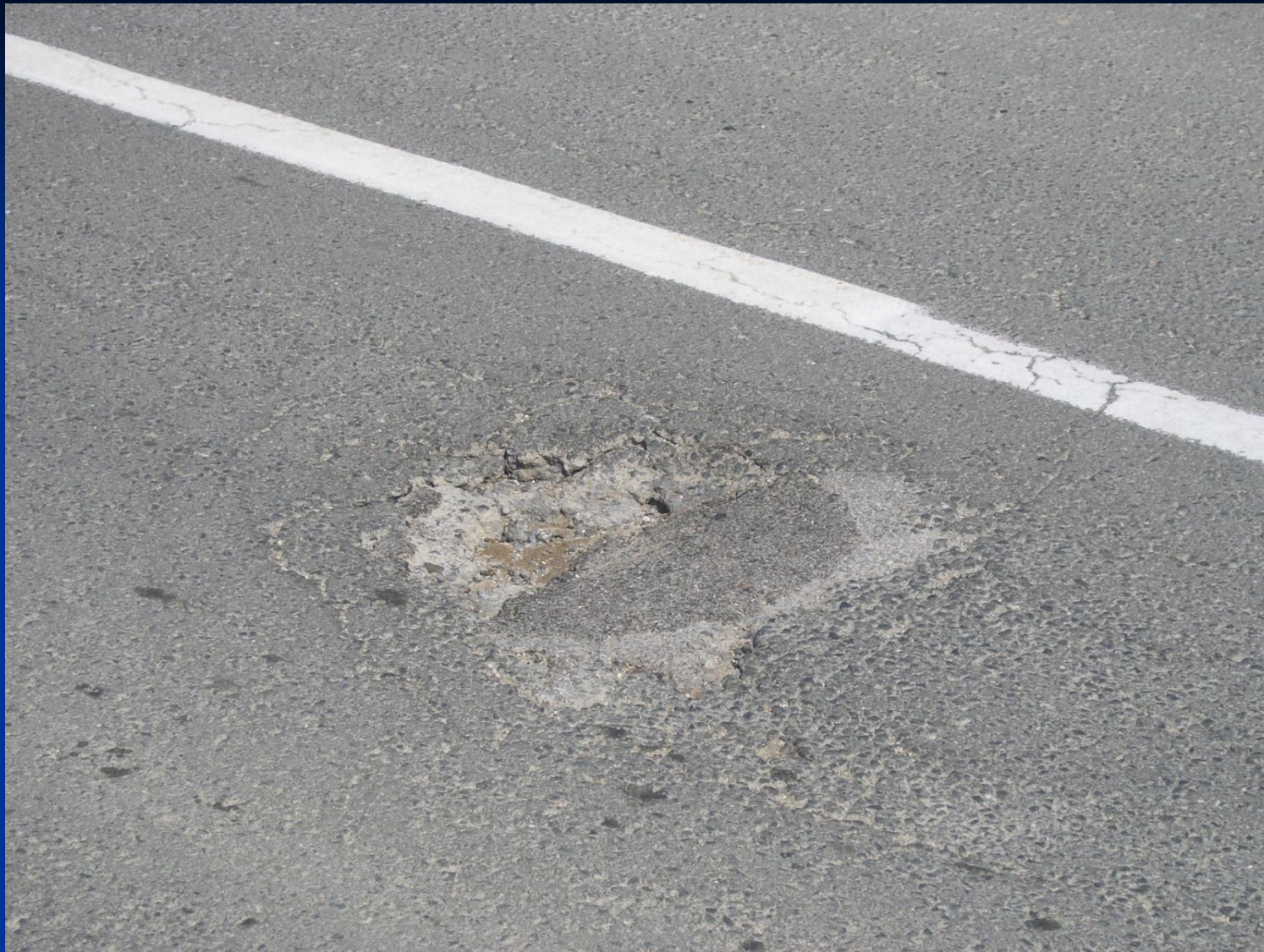
Primjer oštećenja asfaltnog kolnika
