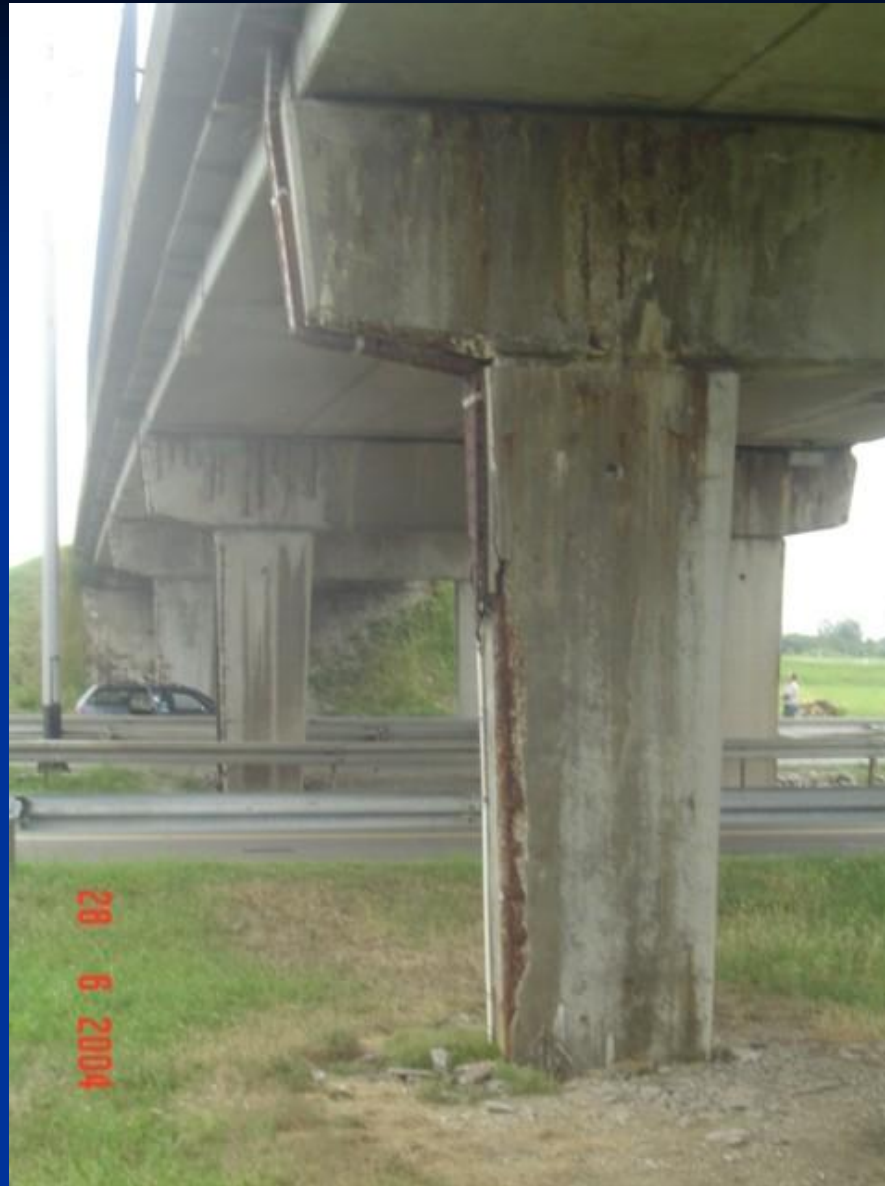
Pogled na nadvožnjak okomito na smjer autoceste, oštećeno stupište nadvožnjaka
