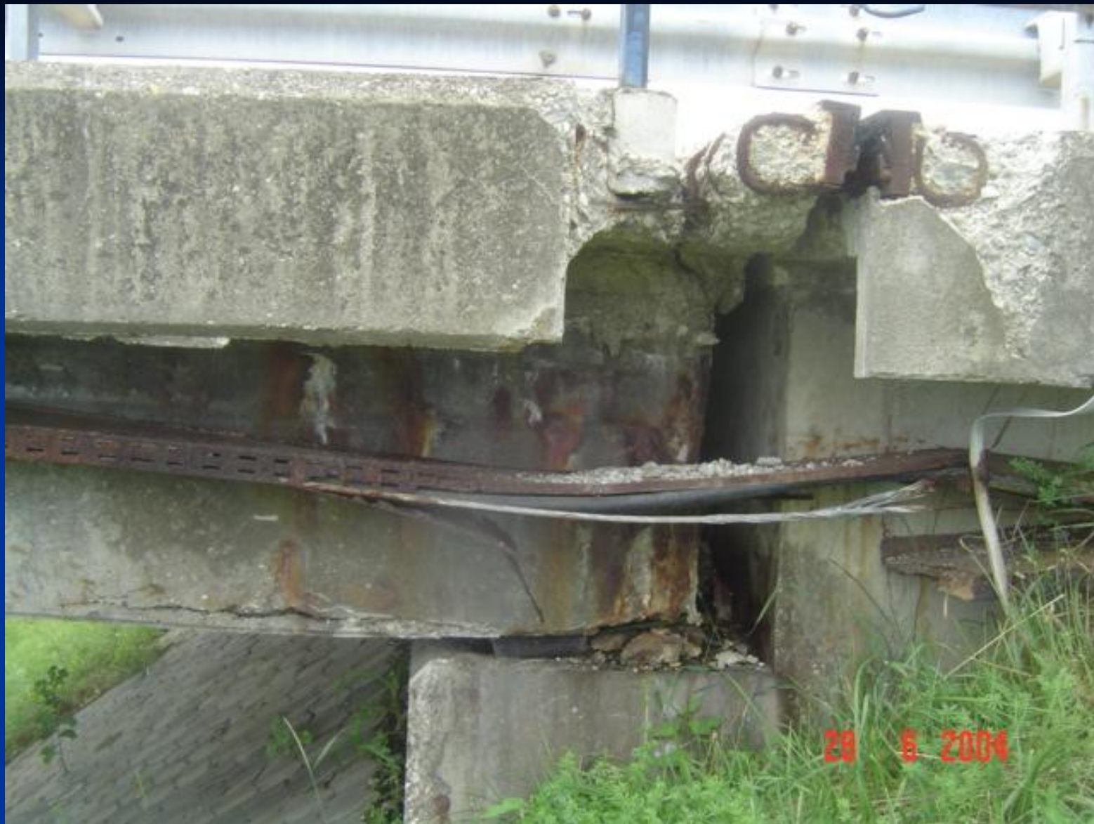
Detalj oslanjanja rasponske konstrukcije na ležaj na mjestu upornjaka, oštećena dilatacijska naprava
