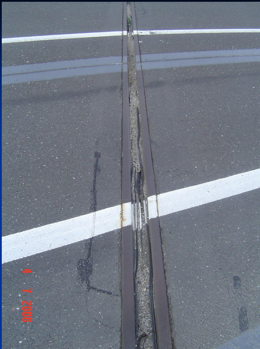
Neodržavana dilatacijska naprava
