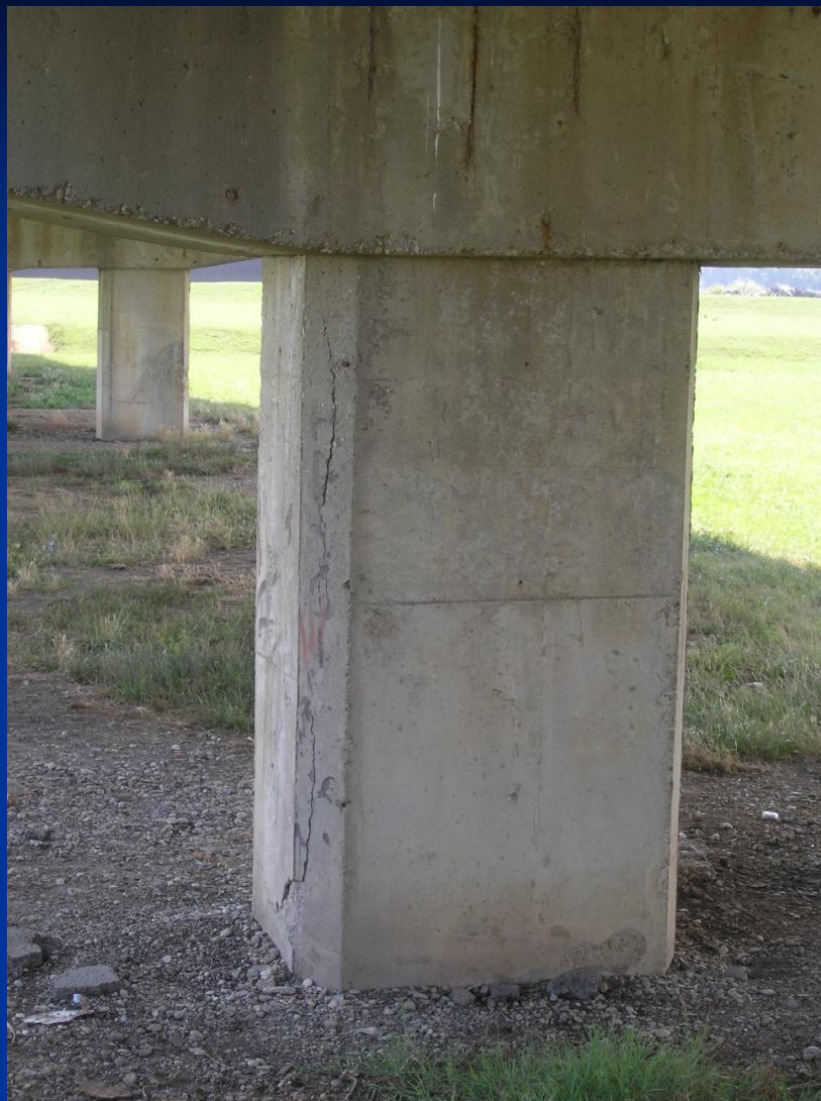
Izgled manje oštećenog stupa i naglavne grede
