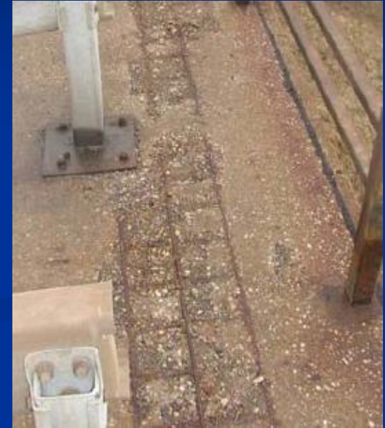
Vidljiva armatura pješačke staze
