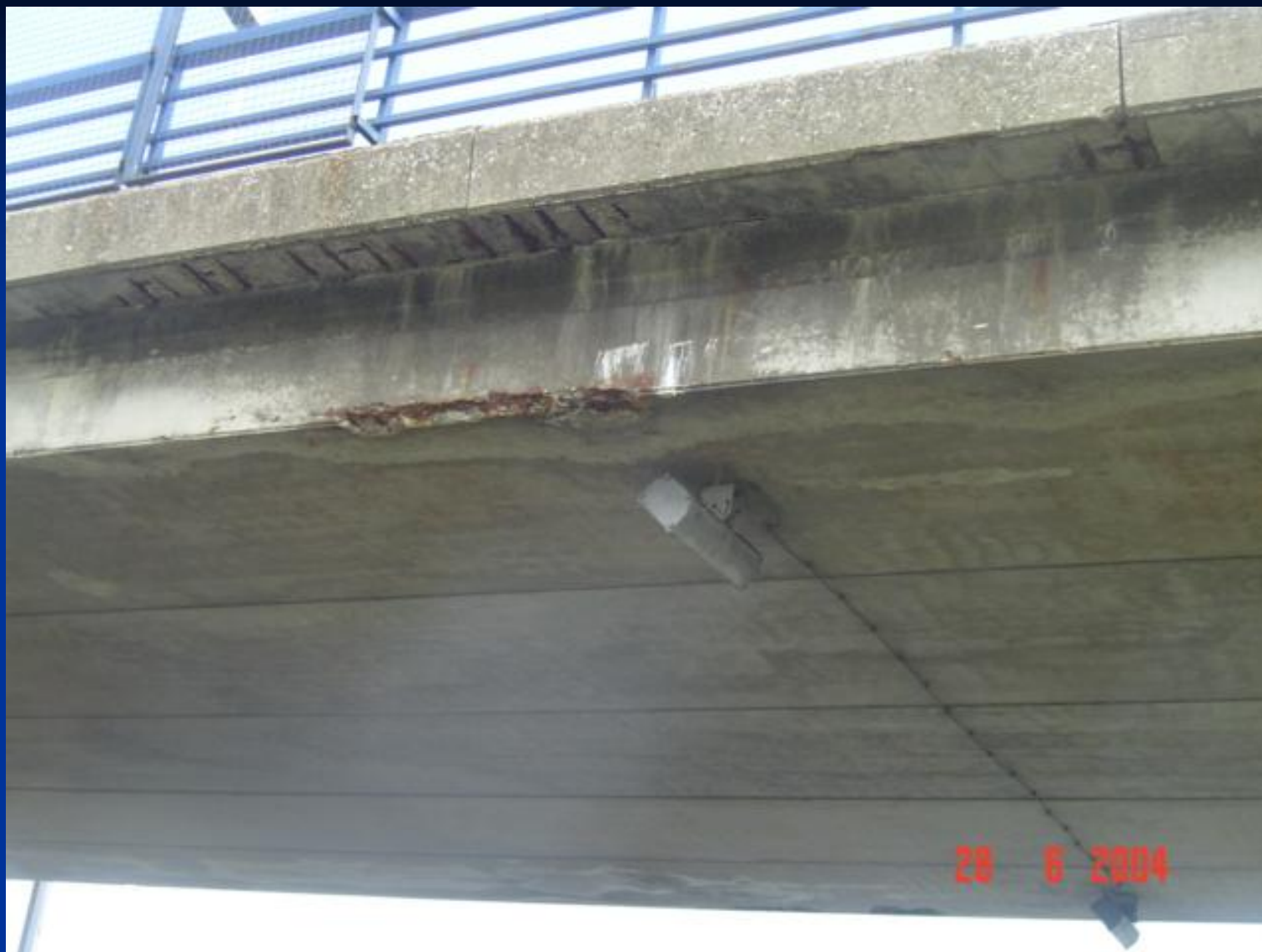
Rasponska konstrukcija u dobrom stanju, oštećenja su vidljiva na poziciji pješačkog hodnika
