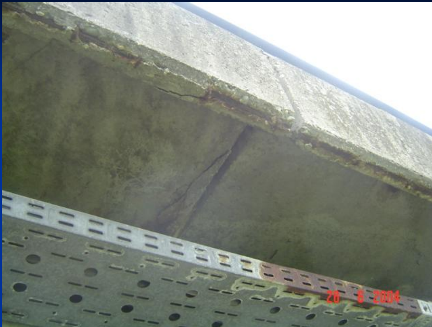
Korozija armature na montažnim maskama
