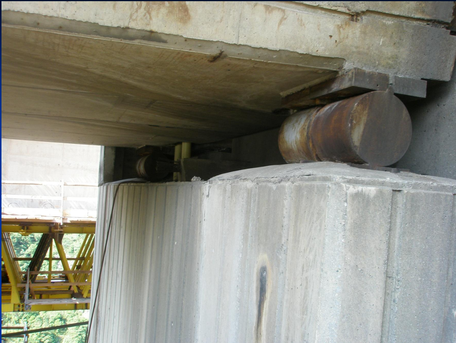
Primjer oštećenja čeličnih ležajeva
