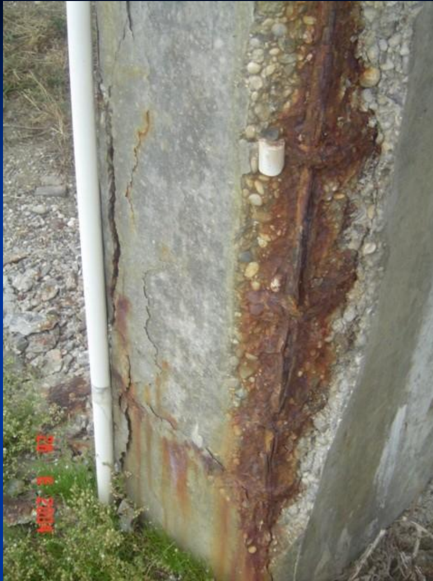
Detalj stupišta na kojem je vidljivo odlamanje betona uslijed koroziije armature
