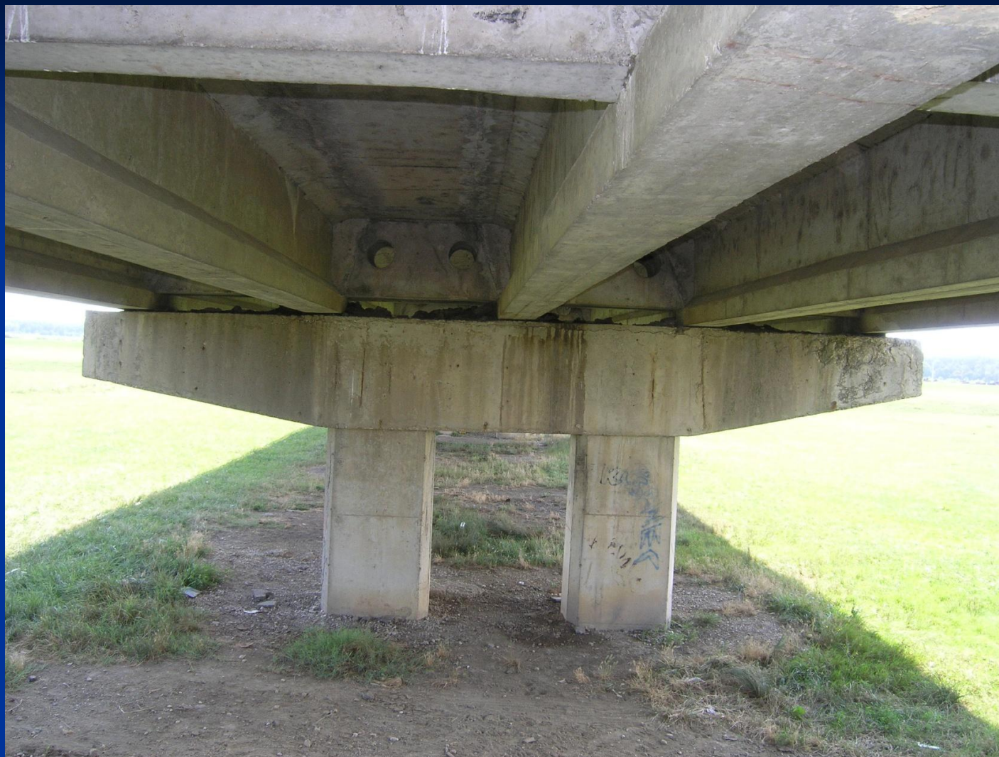
Pogled na donji i podgled gornjeg ustroja nadvožnjaka, neznatnija oštećenja konstruktivnih elemenata
