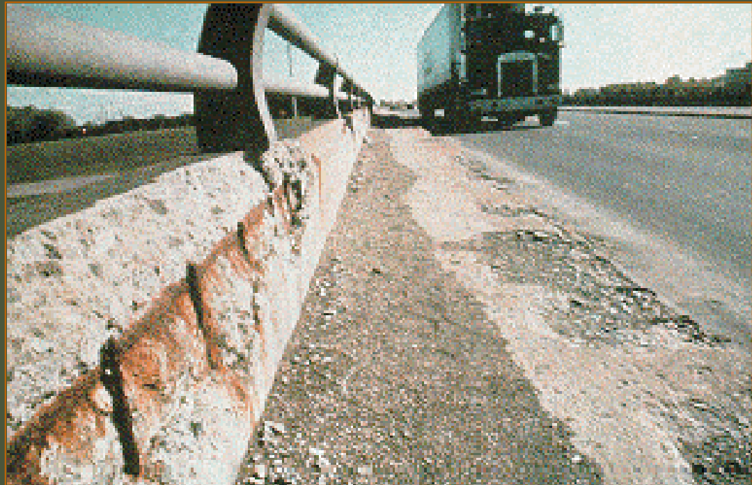
Propadanje betonske ograde od djelovanja soli za odmrzavanje
