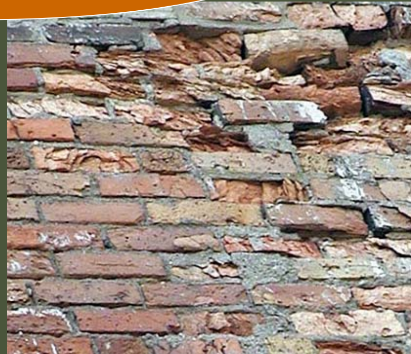
Odlamanje zidnih elemenata kao posljedica smrzavanja
