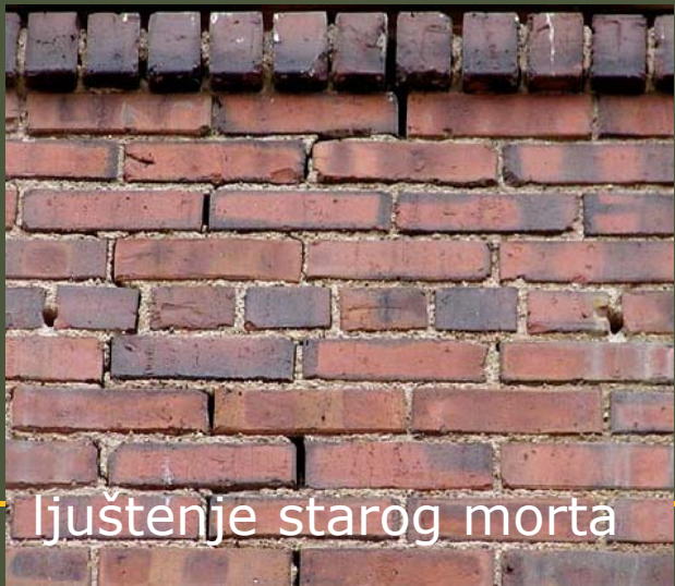
Gubitak veze između zidnog elementa i morta
