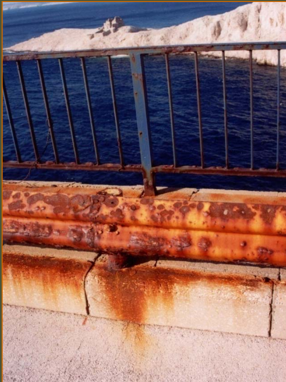
Korozija čelične ograde
