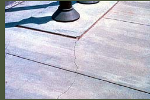
Pukotine u mladom ali već očvrslom betonu
