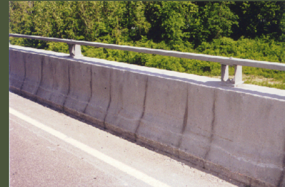
pukotine uzrokovane promjenama temperature, vibracijama od prometa i skupljanjem betona
