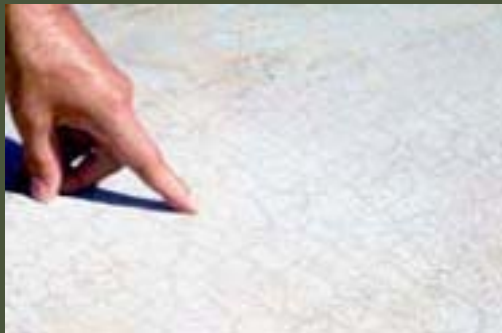
Mrežaste pukotine od skupljanja površinskog sloja
