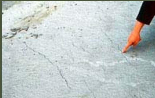
Paralelne pukotine u svježem betonu
