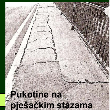
Poprečne pukotine kolničkog zastora
