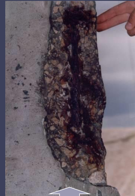
Korozija prednapetih kabela, agresivan okoliš – mali zaštitni sloj betona
