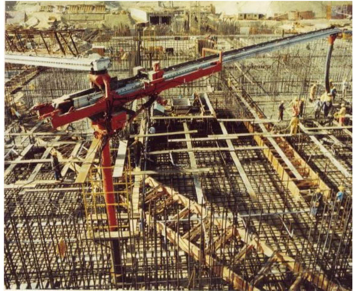
sustav transportnih traka (razdjelna transportna traka na kraju sustava)
