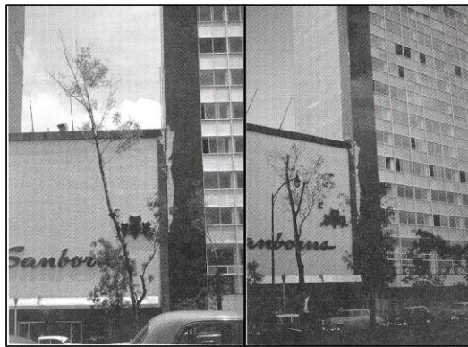
Slika 37.: Oštećenje zgrada na seizmičkoj dilataciji
