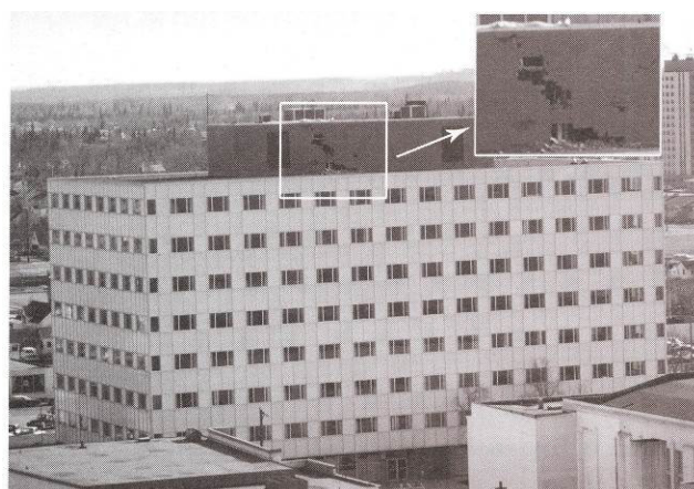
Slika 231.: Primjer oštećenja zgrade s podatljivim katom
