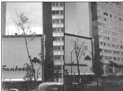
Slika 37.: Oštećenje zgrada na seizmičkoj dilataciji
