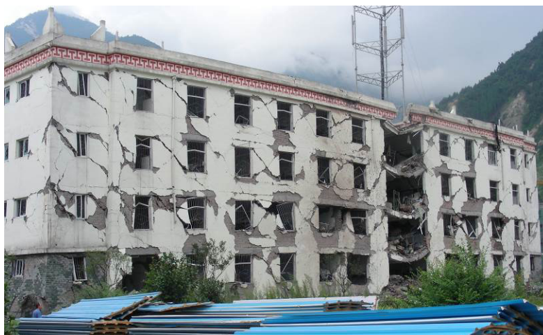
Slika 25.: Primjer zgrade oštećene u potresu (pokrajina Wenchuan, Kina) http://nees-anchor.ceas.uwm.edu/wenchuan_earthquake/eri_lfe_wenchuan.html
