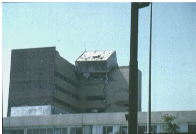
Slika 230.: Primjer oštećenja zgrade u Mexico Cityju s vodospremnikom na vrhu
