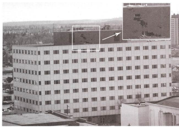
Slika 231.: Primjer oštećenja zgrade s podatljivim katom
