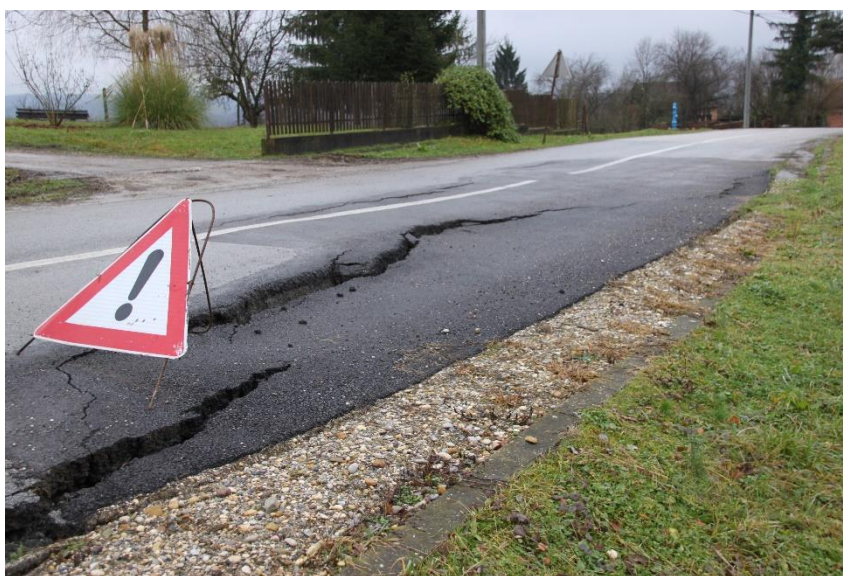
Lokacija 2: vrh klizišta, slijeganje kolnika
