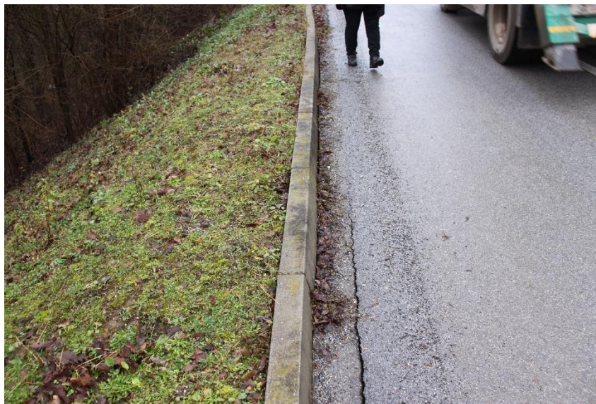
Lokacija 1: nizbrežna strana, odvajanje rubnjaka i kolnika
