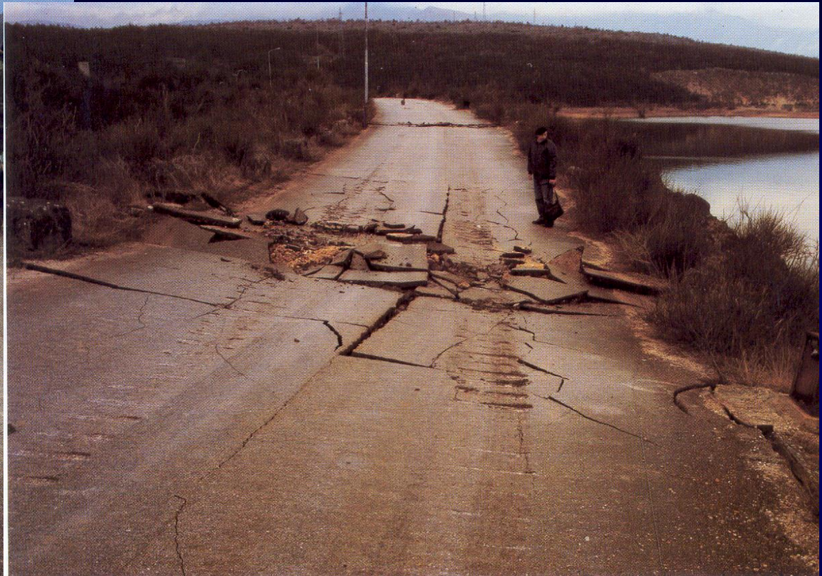
Foto 5. Ulegnuće krune na najvišem dijelu brane
